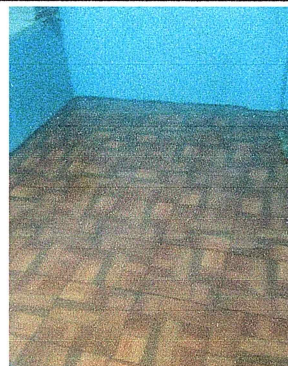
Foto 4: Sustitución del piso antideslizante, debido a que el piso de cemento estaba deteriorado
