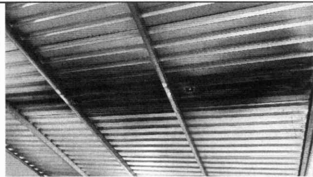
Foto 2: Se observa que la lamina troquelada esta en mal estado por lo que es urgente la sustitucion de la lamina aluzinc calibre 26.
