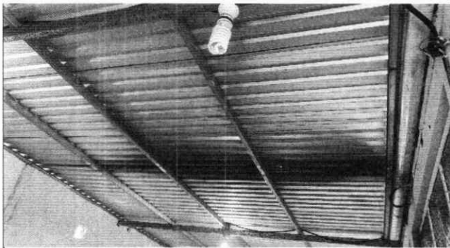
Foto 3: Se observa que la estructura de soporte de metal esta en el estado urge el cambio del mismo.
