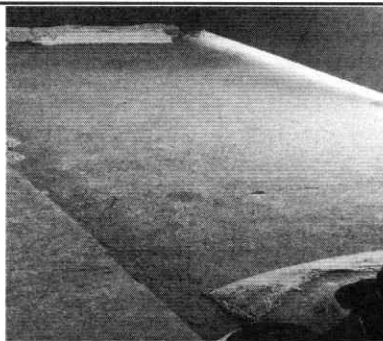
Foto 10: Se observa que la plancha de concreto ya se encuentra en mal estado por lo que urge repación.
