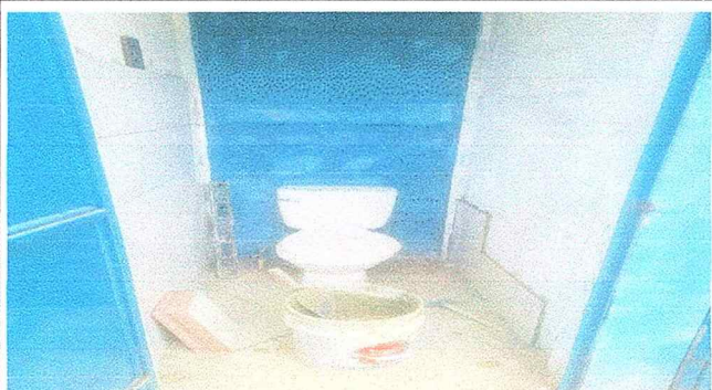
Foto 3: SE OBSERVA QUE YA ESTAN REALIZANDO LA COLOCACIÓN DE AZULEJO EN BAÑOS.
