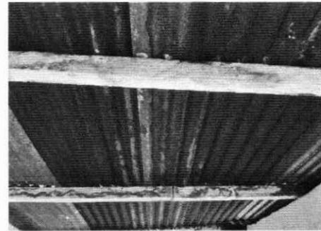
Foto 4: Se observa lámina de cubierta existente necesita sustitución por motivo que tiene filtraciones así mismo sustituir la estructura de madera por metal
