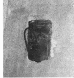
Foto 8: Se ve la necesidad de colocar el sistema eléctrico en ciertas aulas
