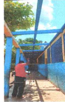
Foto 2: Se observa que estan sustituyendo las costaneras que estan en mal estado.
