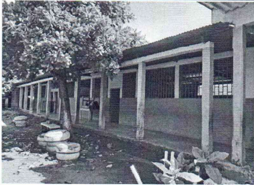
Foto 1: Se observa el módulo de aulas a remozar en cubierta, muros, puertas y ventanas
