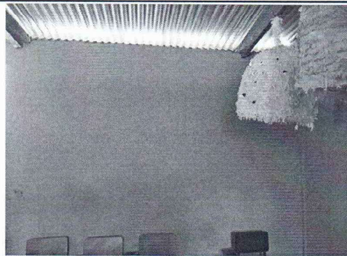
Foto 3: Se observa que aula no cuenta con ventilación cruzada
