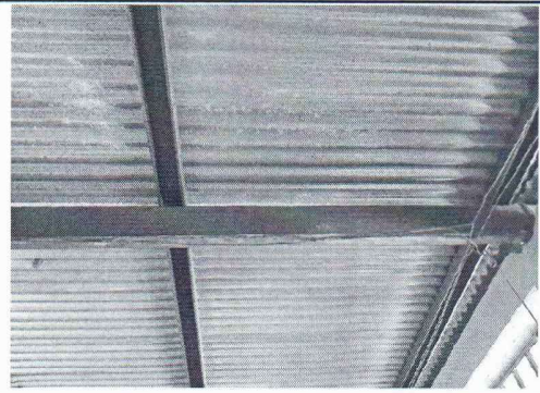
Foto 2: Se observa la lámina de zinc en mal estado y la estructura de soporte necesita mantenimiento. Es necesario sustituir los tendales de madera que ya tienen polilla.
