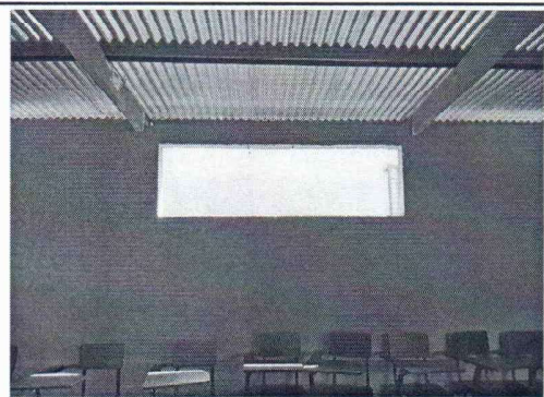
Foto 4: Se observa la necesidad de suministrar balcón en ventanas existentes.
