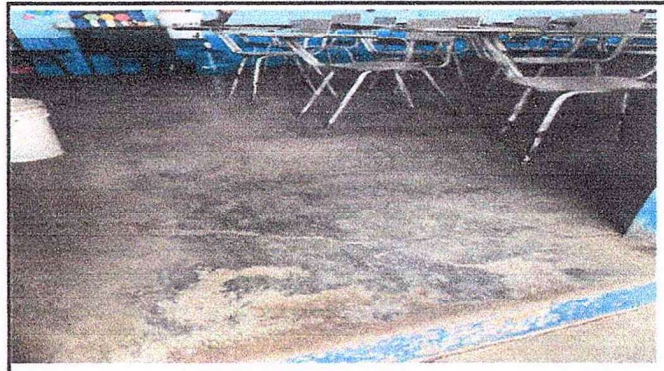
Foto 8: Se observa que el piso de las aulas se encuentran en mal estado.
