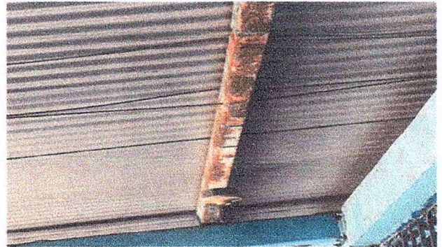
Foto 4: Se observa la necesidad de sustituir estructura de metal por metal
