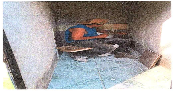
Foto 14: SE OBSERVA QUE SE ESTA TRABAJANDO EL LAVAMANOS EN MAL ESTADO.
