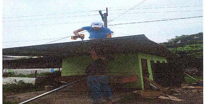
Foto 16: SE OBSERVA QUE SE ESTA TRABAJANDO EN LA CUBIERTA DE LOS SERVICIOS SANITARIOS.
