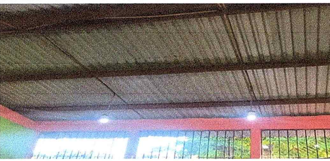
Foto 9: SE OBSERVA QUE ESTÁN CAMBIANDO EL SISTEMA ELECTRICO QUE SE ENCUENTRA EN MAL ESTADO
