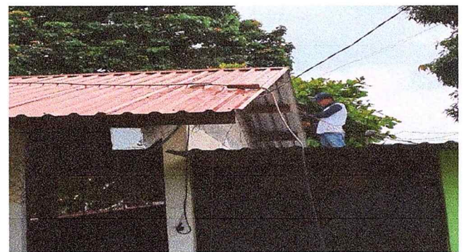
Foto 10: SE OBSERVA QUE LA LÁMINA DE LA CUBIERTA EXISTENTE EN EL MÓDULO 2, ESTA RECIBIENDO MANTENIMIENTO.
