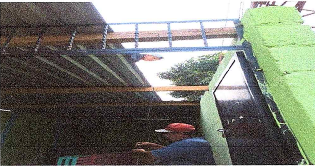
Foto 15: SE OBSERVA LA LÁMINA Y ESTRUCTURA PORTANTE EN MAL ESTADO.
