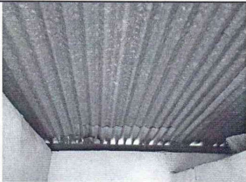
Foto 15: Se observa la lámina y estructura portante en mal estado
