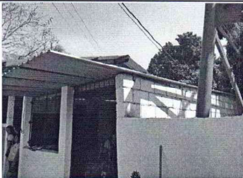
Foto 3: Se observa que cubierta (módulo 1) de lámina carece de mojinete y la altura del muro no es la adecuada
