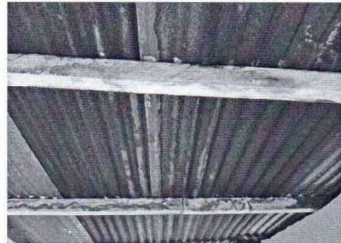
Foto 16: Se observa otra área del mal estado de la cubierta en los servicios sanitarios
