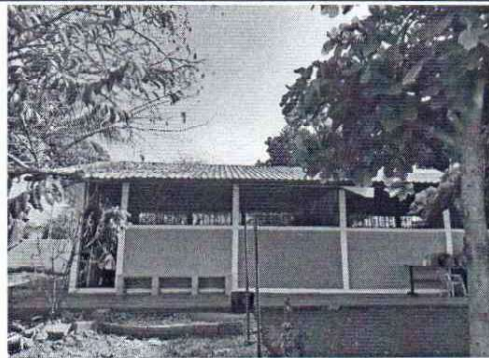
Foto 10: Se observa lámina de la cubierta existente en el módulo 2, necesita mantenimiento
