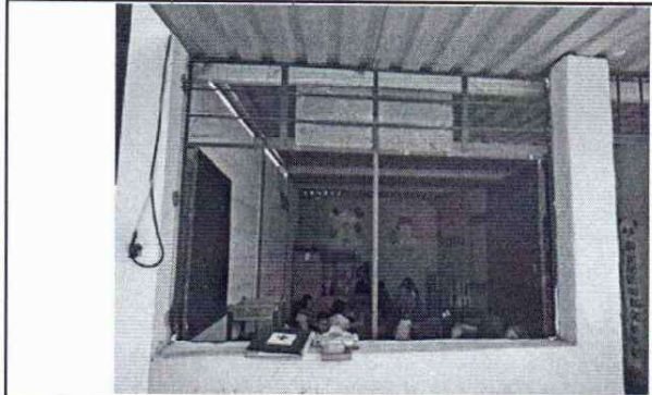
Foto 7: Se observa que ventana existente no es funcional, se debe sustituir por balcón de metal
