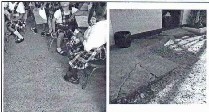
Foto 8: Se observa que el piso, es de concreto (rústico), es necesario mejorarlo. Asimismo es necesario reparar y confoormar piso de concreto en el corredor.
