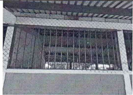
Foto 2: Se observa que balcones necesitan mantenimiento preventivo, asimismo, es necesario proteger el interior de las aulas con ventanas
