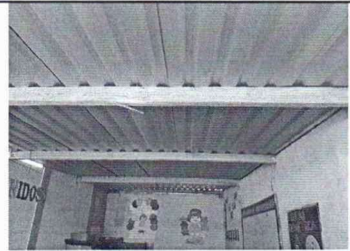
Foto 4: Se observa que la cubierta del módulo de aulas 1, necesita sustitución
