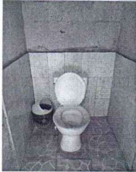
Foto 13: Se observa el inodoro en mal estado, urge su sustitución. Asimismo, es necesario dar mantenimiento a los muros internos con azulejo y pintura latex acrílica
