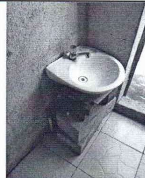
Foto 14: Se observa el lavamanos en mal estado, urge su sustitución
