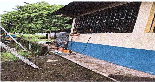
Foto 5: Se observa que se necesita aplicación de pintura.
