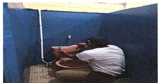
Foto 6: Se observa que están realizando la repación del inodoro.
