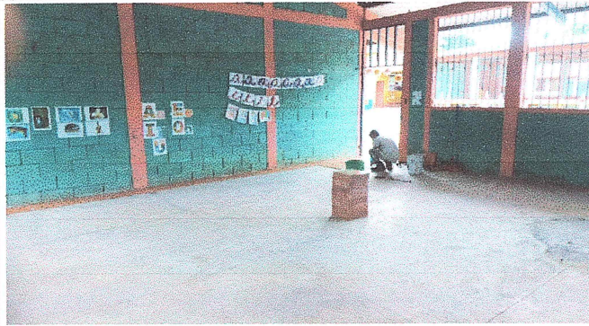
Foto 13: Se observa el mantenimiento del módulo 2.
