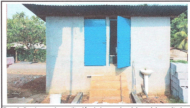
Foto 6: Se observa la sustitución de las gradas del servicio sanitario.
