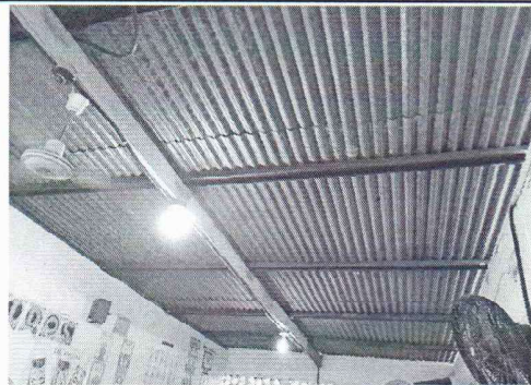
Foto 2: Se observa que módulo de aulas 1 tiene la lámina y estructura de metal en mal estado, urge su sustitución. Además es necesario sustituir el sistema eléctrico, el cual se dañará al desmontar la cubierta.
