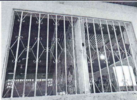
Foto 5: Se observa que balcones necesitan mantenimiento preventivo
