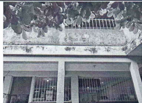
Foto 6: Se observan que los muros necesitan mantenimiento
