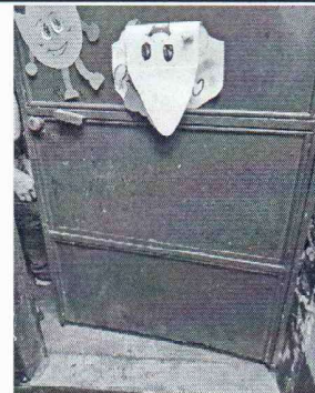
Foto 4: Se observa que la puerta del módulo de aulas 1, está en mal estado y el piso necesita mejora
