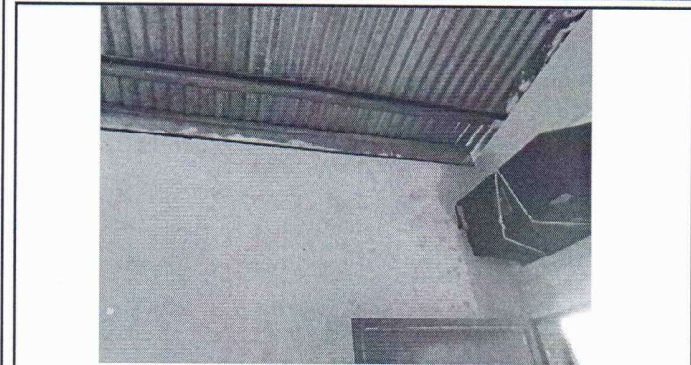
Foto 7: Se observa que el canal ubicado en el módulo de aulas 2, ya no funciona correctamente
