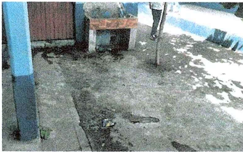
Foto 9: Se observa que el piso de concreto se encuentra en mal estado.
