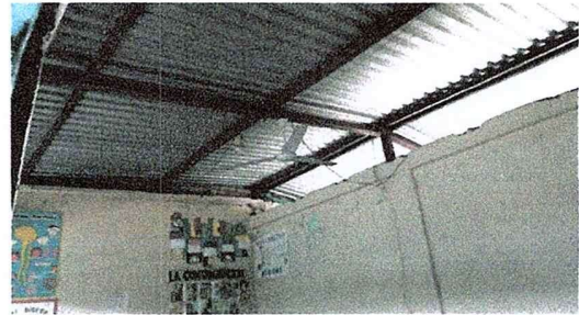
Foto 10: Se observa que el sistema electrico se encuentra en mal estado.
