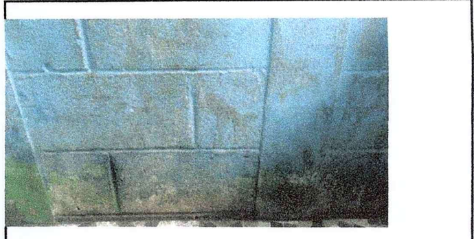
Foto 20: Se observa que las paredes necesitan ser pintadas.
