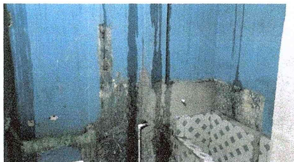
Foto 4: Se observa que el azulejo en baños está en mal estado
