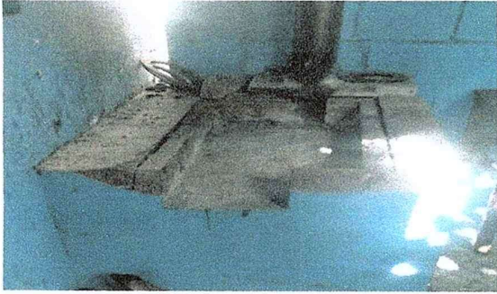
Foto 7: Se observa estufa en mal estado.
