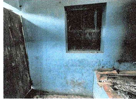
Foto 8: Se observa ventana para despacho pequeña y alta, dificultando servicio de alimentación para grados pequeños
