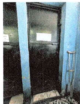
Foto 2: Se observa que las puertas de los servicios sanitarios están mal estado.
