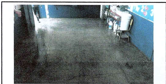
Foto 15: Se observa piso en mal estado.
