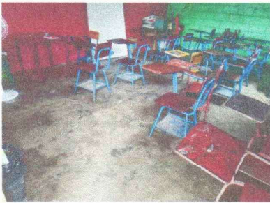
Foto 1: Se observa el piso deteriorado en todas los salones de clase de la escuela.
