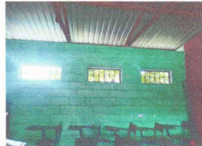
Foto 4: Se observan las aulas con poca ventilación e iluminación natural.
