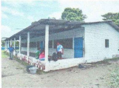
Foto 3: Se observan los salones y el exterior de las aulas, con la pintura desgastada.
