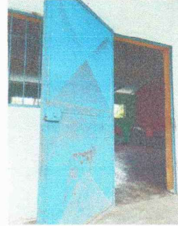
Foto 2: Se observa las puertas sin chapa y deterioradas de la pintura en todas las aulas de la escuela.
