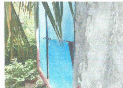
Foto 6: Se observa las puertas de los baños con daños considerables
