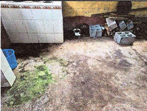
Foto 3: Se observa que no cuenta con piso cerámico y el mismo en mal estado
