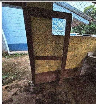
Foto 9: Se observa puerta de cocina dañada, no funcional y de madera.
