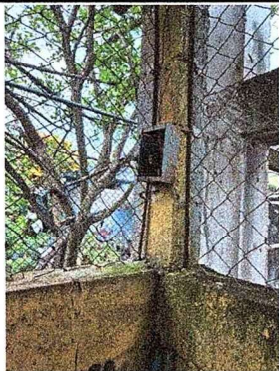
Foto 7: Se observa tablero de bomba en mal estado y sin iluminación y fuerza en el área de cocina.
