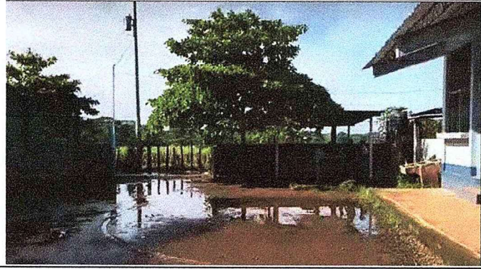
Foto 13: Se observa patio de terracería que empoza agua de lluvia.
