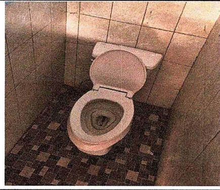
Foto 14: Se observa fuga de agua constante en inodoro.
