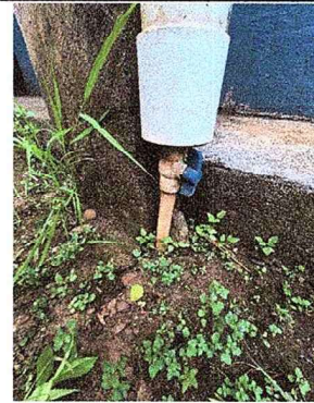
Foto 16: Se observa tubería principal de agua potable muy pequeña y con bajo caudal y presión en chorros
