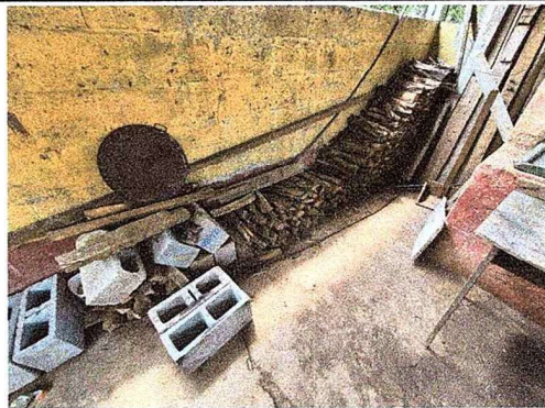
Foto 8: Se observa pintura interior y exterior con desgaste y deterioro.
