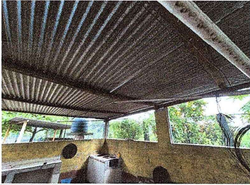
Foto 1: Se observa la lámina deteriorada urge cambio
