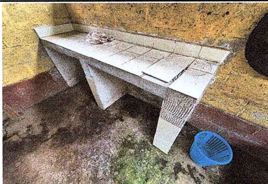
Foto 10: Se observa mueble de cocina con azulejo dañado.
