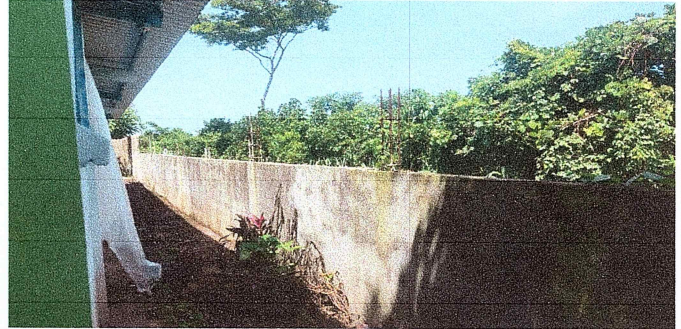
Foto 2: reparacion de muro perimetral de block se realizo solo una parte según acta numero 28-2024.
