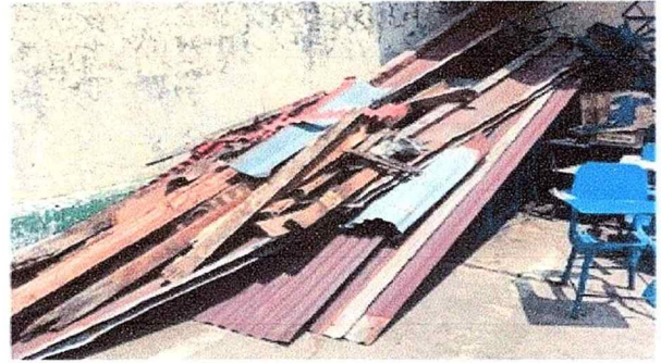
FOTO 2: SE TIENE A LA VISTA LA LAMINA DAÑADA Y LA ESTRUCTURA DE SOPORTE EN MADERA EN MAL ESTADO QUE SE REMOVIERON
