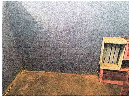
Foto 14: Se observa que al momento de colocar la pila en la cocina no cuenta con agua potable, se irán agarrar de los chorros exteriores y entrará por esta área para la pila
