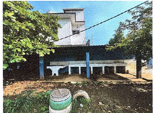
Foto 10: Se observa que la plancha de concreto en mal estado y con undimientos en algunas áreas
