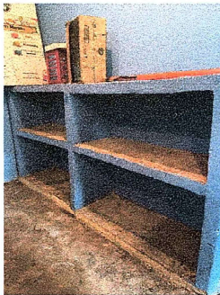
Foto 23: Se observa la falta de azulejo en muebles y mesas
