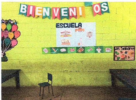
Foto 5: Se boserva que las paredes se encuentran sucias
