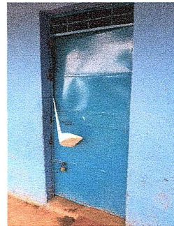
Foto 18: Se observa que la puerta no está reforzada se encuentra doblada y la chapa ya no sirve, en la parte interior tiene óxido
