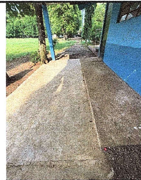
Foto 6: Se observa la falta de piso ceramico
