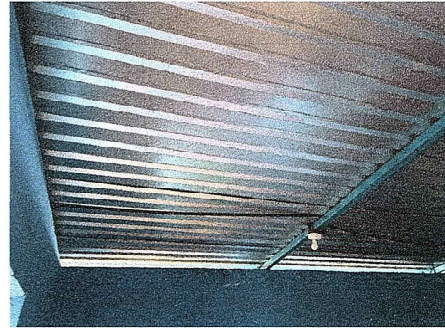
Foto 22: Se observa espacio entre el techo y el muro y el ladron tiende a meterse en esa area
