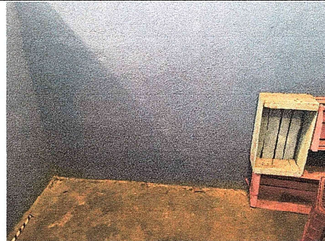
Foto 16: Se observa que la cocina no cuenta con una pila
