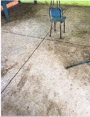
Foto 1: Se observa la falta de piso ceramico
