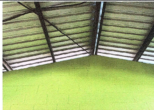
Foto 4: Se observa que entre la pared y el techo de lamina hay una abertura y los ladrones tienden a meterse por esa area
