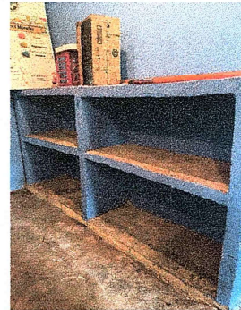
Foto 20: Se observa que el almacenamiento no cuenta con puertas, y los ladrones tienden a meterse en el area
