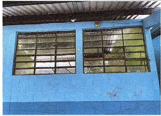
Foto 2: Se observa que cuenta con corrosion, y al abrirlas se quedan trabadas
