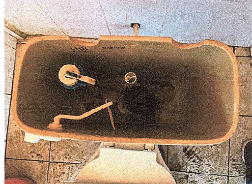
Foto 8: Se observa que sus componentes se encuentran en mal estado y ya no cumplen su función, y el agua tiende a filtrarse por la unión del suelo y el inodoro
