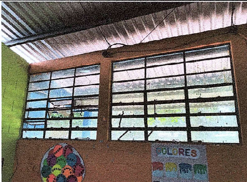
Foto 3: Se observa las paletas de cristal estan en mal estado y cuenta con paletas de cristal quebradas
