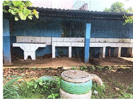
Foto 12: Se observa que las paredes se encuentran en mal estado
