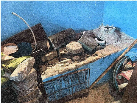
Foto 15: Se observa que la estufa rural se encuentra en mal estado
