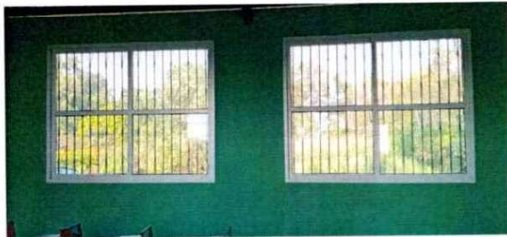
Foto 3: Las ventanas están muy deterioradas, el vidrio por estar quebrado tiende a caerse en cualquier momento y es un riesgo para los estudiantes, por lo que es necesario su sustitución.
