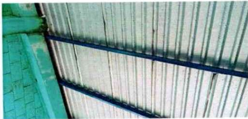
Foto 5: La estructura del techo de las escaleras, se encuentra bastante deteriorado (carcomido por el oxido), por lo que es necesario su sustitución.
