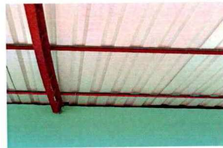
Foto 6: Las láminas se observan oxidadas y deterioradas por lo mismo se deben de sustituir.
