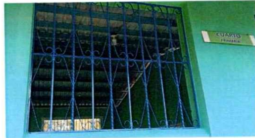
Foto 2: Los balcones presentan deterioro en la pintura y es necesario darle su mantenimiento.
