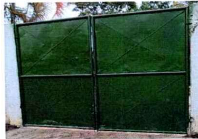
Foto 4: El portón en la parte baja se puede observar que tiene corrosión, se requiere su reparación.
