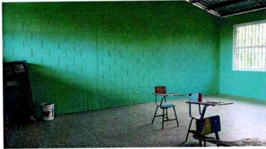
Foto 1: Las paredes presentan deterioro en la pintura por el daño que han sufrido con el tiempo, por lo que es necesario aplicar pintura.
