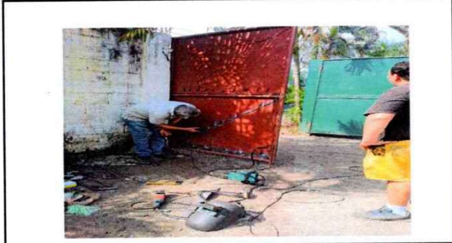
Foto 4: El porton en la parte baja se puede observar que tiene corrosión, por lo mismo se le está dando su mantenimiento.
