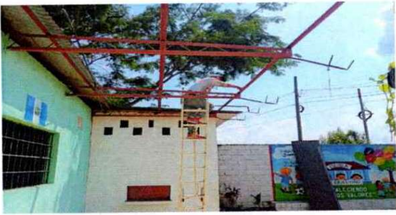
Foto 7: la estructura de metal del corredor necesita mantenimiento y con el cambio de lamina, se está dando su mantenimiento.
