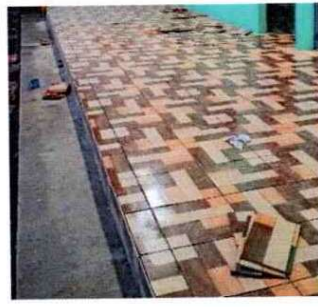
Foto 8: El cambio de piso ya es notorio y está en proceso de culminación.
