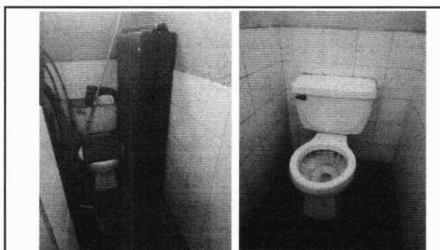
Foto 4: Los servicios sanitarios están severamente dañados, incluso se puede observar que hay uno que ya no se utiliza debido a que no hay suficiente agua y colapsaron, es necesario sustituirlos.
