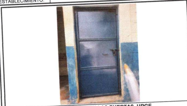
FOTO 1: SE OBSERVA EL ÓXIDO EN LAS PUERTAS, URGE MANTENIMIENTO.
