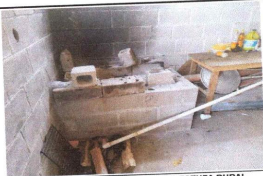
FOTO 9: SE OBSERVA EL MAL ESTADO DE LA ESTUFA RURAL.
