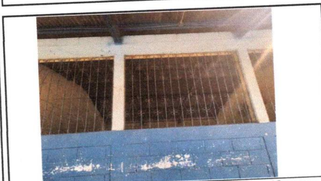
FOTO 3: SE OBSERVA EL ÓXIDO Y FALTA DE PINTURA EN LOS BALCONES.
