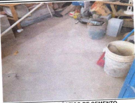
FOTO 7: SE OBSERVA EL PISO RÚSTICO DE CEMENTO.
