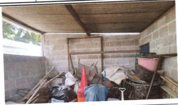
FOTO 8: SE OBSERVA EL DETERIORO DE LÁMINAS Y ESTRUCTURA DE SOPORTE QUE ES DE MADERA, URGE SUSTITUCIÓN.
