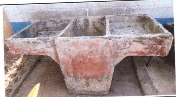
FOTO 12: SE OBSERVA EL DETERIORO DEL CONCRETO DE LA PILA Y LA FALTA DE CHORRO.
