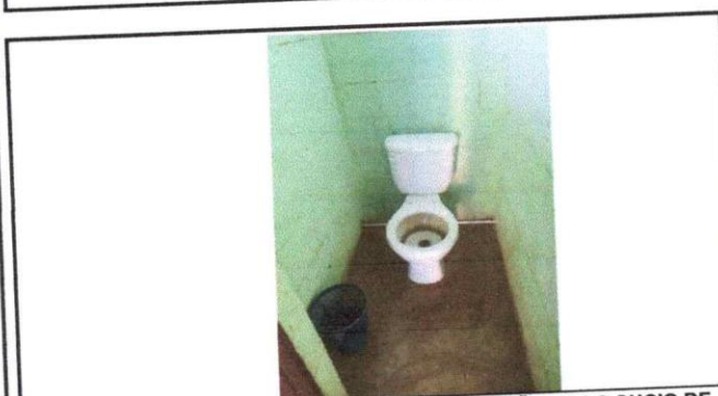
FOTO 5: SE OBSERVA EL MAL ESTADO DE LOS BAÑOS Y LO SUCIO DE LAS PAREDES POR FALTA DE AZULEJO.
