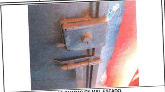
FOTO 2: SE OBSERVA LAS CHAPAS EN MAL ESTADO.
