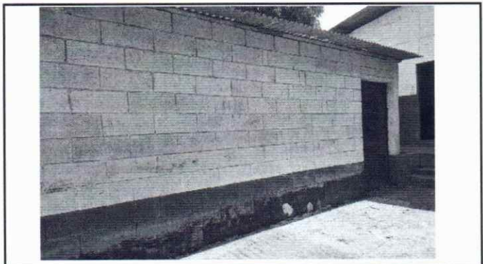
FOTO 4: SE OBSERVA LA PAREDES SUCIAS Y SIN PINTURA.
