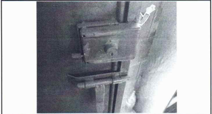
FOTO 2: SE OBSERVA LAS CHAPAS EN MAL ESTADO.
