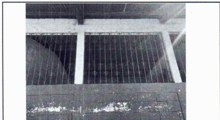
FOTO 3: SE OBSERVA EL ÓXIDO Y FALTA DE PINTURA EN LOS BALCONES.
