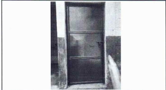
FOTO 1: SE OBSERVA EL ÓXIDO EN LAS PUERTAS, URGE MANTENIMIENTO.
