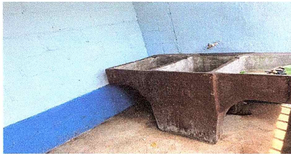
Foto 5: SE OBSERVA QUE SE SUSTITUYO LA PILA, EL PISO RECIBIO MANTENIMIENTO Y MUROS NECESITAN MEJORAS.
