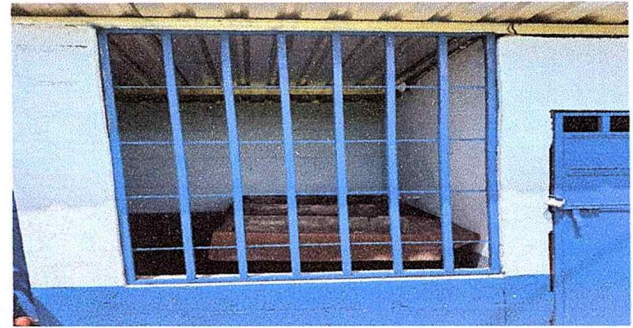
Foto 2: SE OBSERVA QUE SE SUSTITUYO LA VENTANA DEL MÓDULO DE SERVICIOS SANITARIOS POR Balcón DE METAL.
