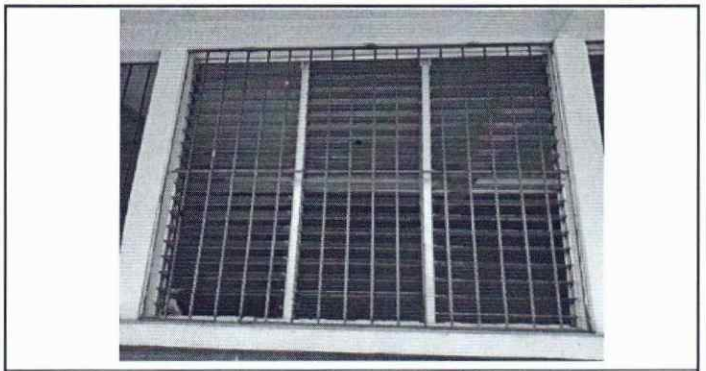
Foto 12: Se observa que balcones de metal de módulo de aulas 2, necesitan mantenimiento preventivo
