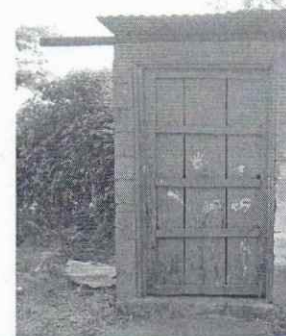
Foto 6: Se observa la puerta de madera en mal estado, urge sustituirla
