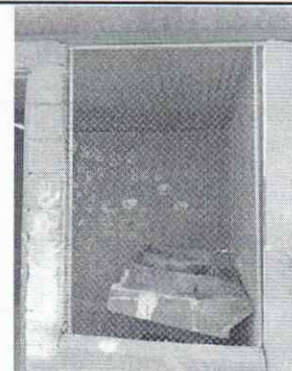
Foto 2: Se observa el mal estado de la ventana de malla y metal del módulo de servicios sanitarios, es necesario sustituirla por balcón de metal
