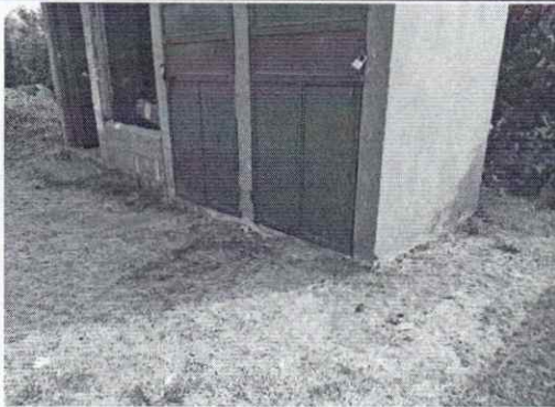
Foto 3: Se observa que módulo de servicios sanitarios, carece de banqueta, también es necesario darle mantenimiento a los muros exteriores
