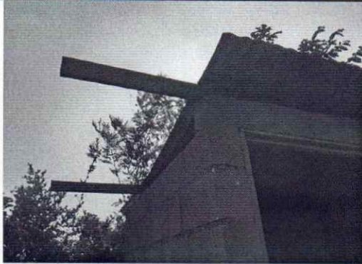
Foto 1: Se observa el mal estado de la lámina y estructura de soporte de metal del módulo de servicios sanitarios, es necesario su sustitución
