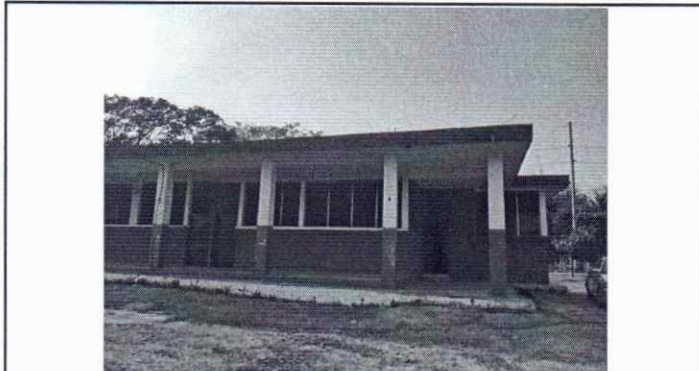
Foto 9: Se observa que los muros del módulo de aulas 1, necesitan mantenimiento preventivo
