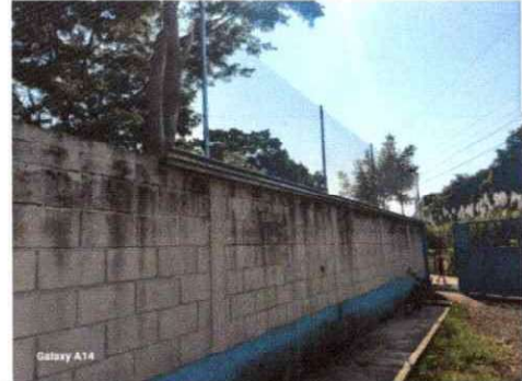
Foto 2: Se observa que se inició con el resane y limpieza de muros exteriores para aplicar la pintura.
