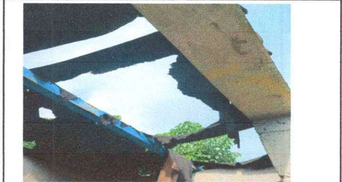
Foto 2. Se Observa las laminas en mal estado por lo que es necesario sustituir las
