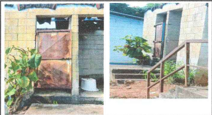
Foto 3. Se Observa la daño por oxidación de las puertas de los baños por lo que se necesita cambio de puertas
