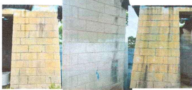
Foto 7. Se Observa paredes en mal estado por lo que se necesita repellar las paredes
