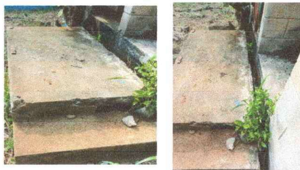
Foto 10. Se observan la necesidad de reparación de las torta de cemento
