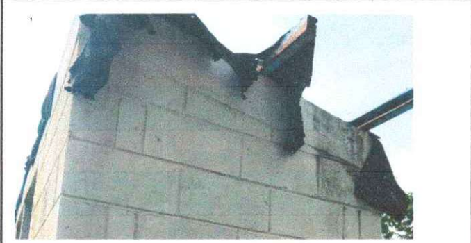
Foto 1. Se Observa el techo en mal estado es necesario sustituir la Estructura metalica y la lamina
