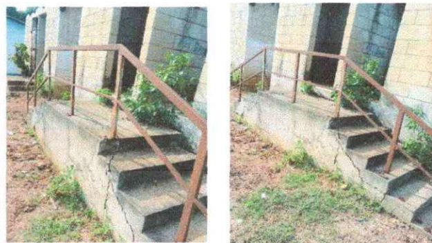
Foto 8. Se observa el deterioro de los barandales por lo cual se necesita cambio
