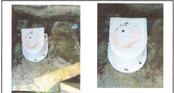
Foto 4. Se observan la necesidad de cambio de inodoro para mejora de los baños
