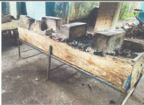
Foto 5: Se observa el estado actual de los polletones en mal estado.
