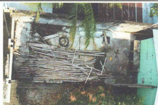
Foto 6: Se observa en planta el espacio donde debe colocarse el piso antideslizante.
