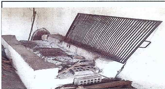
FOTO 4: SE OBSERVA EL DETERIORO DEL BLOCK EN LA ESTUFA.
