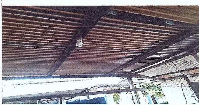
FOTO 2: SE OBSERVA ESTRUCTURA DE MADERA APOLLILLADA, URGE SUSTITUCION A METAL.
