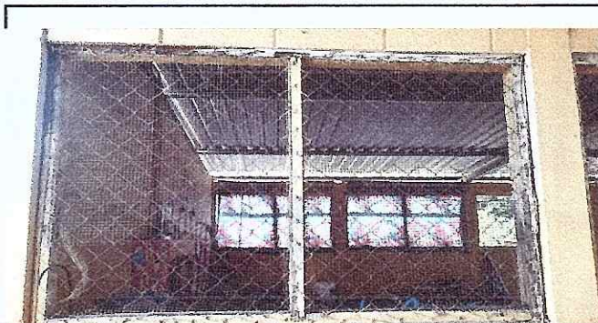
FOTO 3: SE OBSERVA EL MAL ESTADO DE LOS BALCONES DE MALLA.
