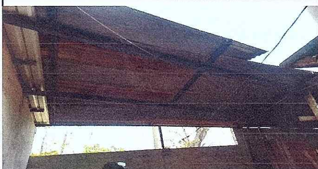
FOTO 1: SE OBSERVA ÓXIDO Y EL MAL ESTADO EN LAS LÁMINAS, URGE SUSTITUCIÓN.
