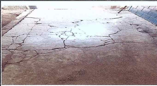
FOTO 7: SE OBSERVA EL MAL ESTADO Y DETERIORO DEL CONCRETO.
