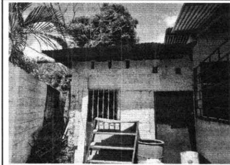
Foto 1: Se observa que la lamina necesita cambio por deterioro, es necesario el cambio de lamina trokelada calibre 26 aluzinc.
