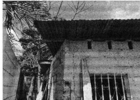
Foto 2: Se observa que la estructura de madera necesita cambios por deterioro, por soporte de metal urge.
