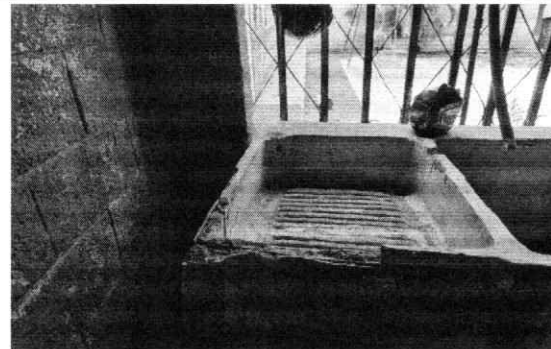
Foto 4: Se observa que la pared esta en mal estado y requiere de mantenimiento en los muros.
