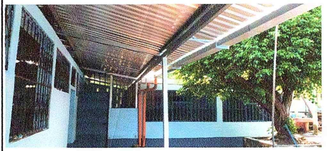
Foto 1: SE OBSERVA EN BUEN ESTADO LA LÁMINA Y ESTRUCTURA DE SOPORTE DE METAL DE LA COCINA Y BODEGA,
