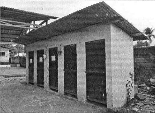
Foto 9: Se observa que los muros exteriores del módulo de letrinas, necesitan mantenimiento preventivo
