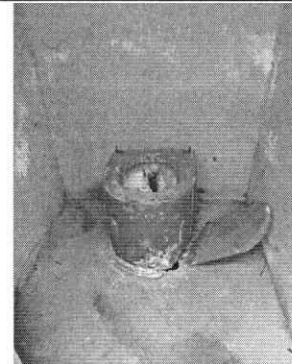
Foto 10: Se observa que letrinas necesitan sustitución. Asimismo, es necesario proteger los muros exteriores con azulejo y pintura. De igual manera mejorar el piso existente.
