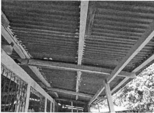
Foto 1: Se observa el mal estado de la lámina y estructura de soporte de metal de la cocina + bodega, es necesario su sustitución
