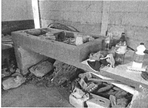
Foto 7: Se observan el mal estado de la estufa de leña, es necesario su sustitución. Asimismo es necesario el suministro de un banco de trabajo de concreto y azulejo
