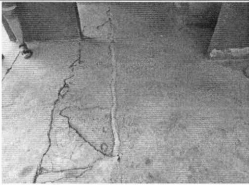
Foto 5: Se observa que el piso de la cocina necesita mejoras
