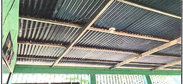
FOTO 2: SE OBSERVA EL MAL ESTADO DE LAS ESTRUCTURAS PORTANTES DE MADERA.
