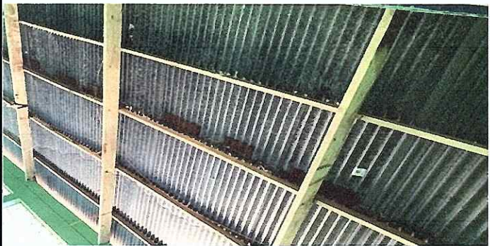
FOTO 3: SE OBSERVA LA LÁMINA ZINC DEL MÓDULO DE AULA CON AGUJEROS Y CORROSIÓN.
