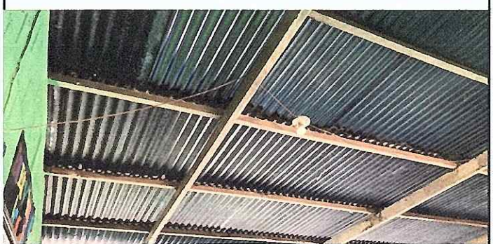
FOTO 4: SE OBSERVA EL MAL ESTADO DE LAS ESTRUCTURAS PORTANTES DE MADERA.
