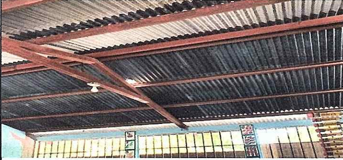
FOTO 1: SE OBSERVA LA LÁMINA DE AULA CON AGUJERO.
