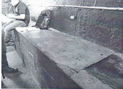
Foto 7: Se observa que el banco de trabajo existente no cumple su cometido, urge sustituirlo. Además es necesario proteger el muro con azulejo
