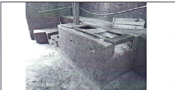
Foto 5: Se observa que la estufa rural existente no es funcional y obstruye, es necesario su sustitución. Asimismo es necesario resanar los muros y aplicar pintura.
