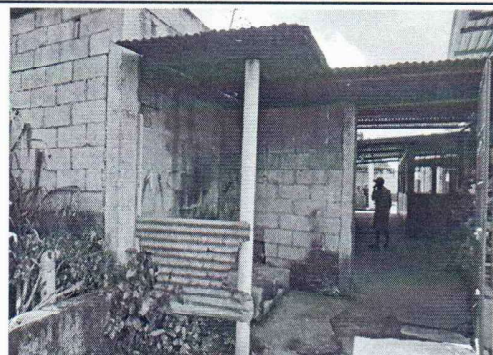
Foto 8: Se observa la necesidad de conformar un muro y suministrar balcones de metal para proteger el área de cocina
