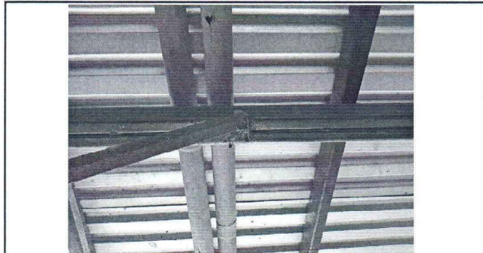
Foto 2: Se observa que estructura de soporte de metal necesita mantenimiento preventivo y correctivo
