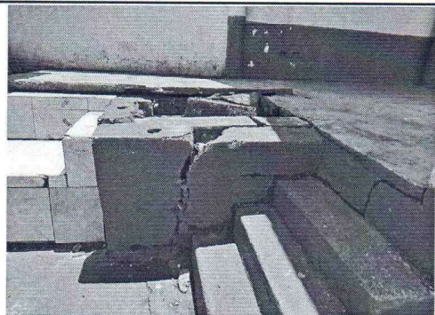
Foto 14: Se observa el piso y módulo de gradas completamente destruido por raíz de árbol, es necesario su sustitución
