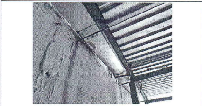
Foto 3: Se observa que canal de metal existente, ya no funciona correctamente, urge su sustitución
