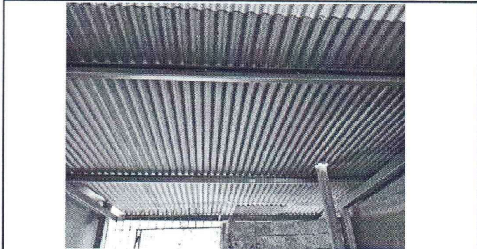
Foto 1: Se observa que lámina de zinc de la cocina, se encuentra dañada por el humo de la estufa rural existente
