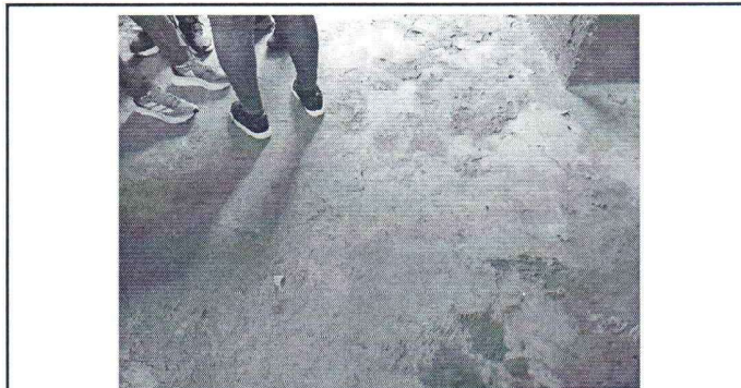
Foto 4: Se observa que el piso de la cocina necesita mejorarse
