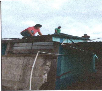
Foto1: SE OBSERVA QUE SE ESTA COLOCANDO LA LAMINA ALUZINC CALIBRE 26 EN MODULO DE AULA.
