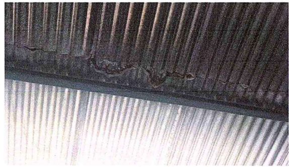
Foto 10: Se observa láminas en mal estado.
