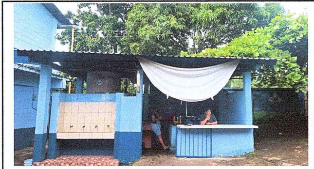
Foto 1: Se observa la carencia de puerta.
