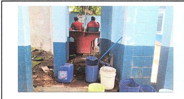
Foto 3: Se observa que la pila se encuentra deteriorada.
