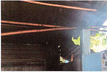
Foto 7: Se observa que las láminas se encuentran dañadas.
