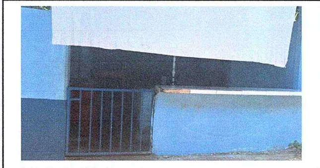
Foto 5: Se observa que el mueble de cocina necesita mejoras.
