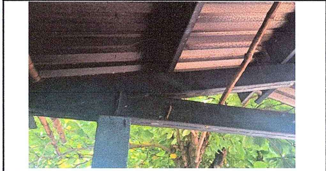
Foto 6: Se observa que la estructura se encuentra dañada.
