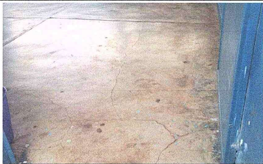
Foto 9: Se observa piso dañado.
