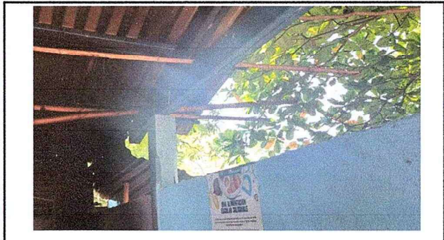
Foto 4: Se observa la carencia de balcones.
