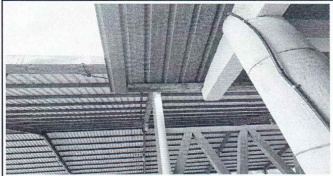
Foto 2: Se observa que la estructura de metal que sostiene el techo esta muy deteriorado.
