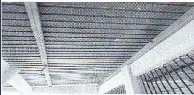
Foto 1: Se observa que las laminas del techo estan en mal estado debido al tiempo que llevan en uso.
