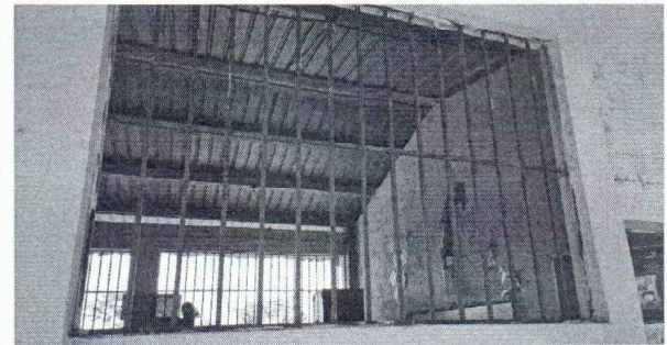
Foto 4: Se observa que balcones de metal en aula dos necesitan mantenimiento.
