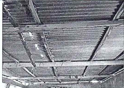
Foto 2: Se observa la lámina de zinc y estructura portante de metal en mal estado, urge su sustitución
