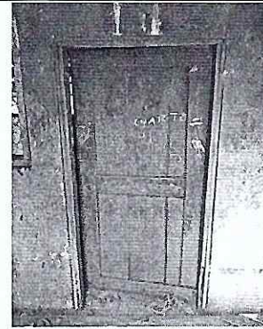
Foto 4: Se observa una de las puertas del módulo de aulas en mal estado, urge su sustitución.
