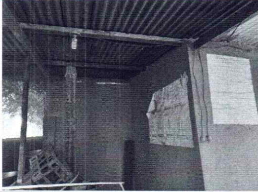
FOTO 1: SE OBSERVA EN LA COCINA EL DETERIORO DE LÁMINAS Y ESTRUCTURA DE SOPORTE QUE ES DE MADERA, URGE SUSTITUCIÓN.
