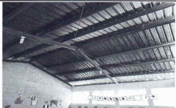
FOTO 8: SE OBSERVA EN EL MÓDULO DE AULAS EL ÓXIDO EN LA ESTRUCTURA DE SOPORTE DE METAL, URGE MANTENIMIENTO.
