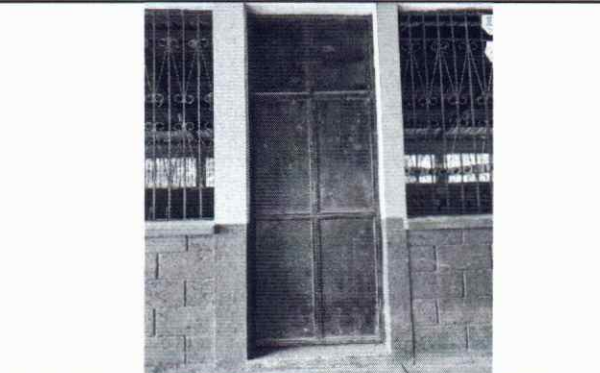
FOTO 10: SE OBSERVA EN MÓDULO DE AULAS EL ÓXIDO EN LAS PUERTAS, URGE MANTENIMIENTO.
