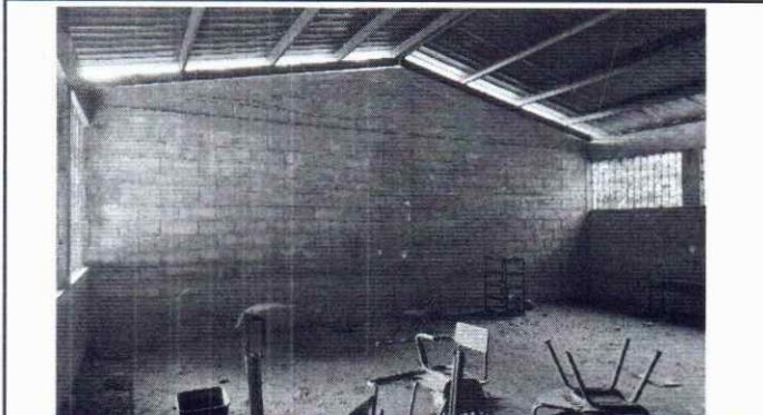
FOTO 9: SE OBSERVA EN MÓDULO DE AULAS LAS PAREDES SUCIAS Y SIN PINTURA.
