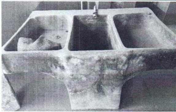
FOTO 3: SE OBSERVA EN LA COCINA EL DETERIORO DEL CONCRETO DE LA PILA.
