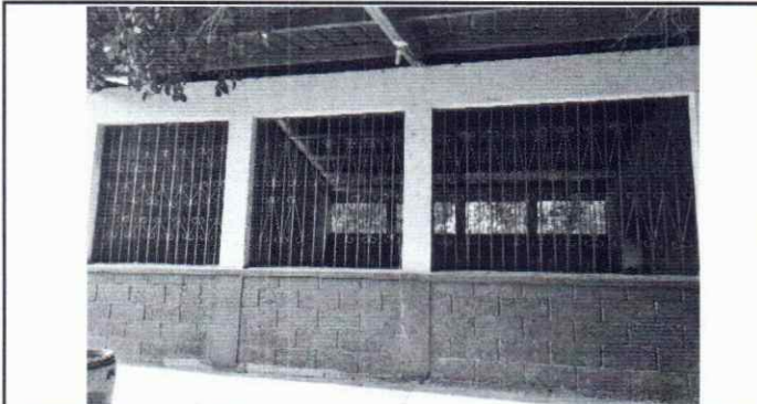
FOTO 11: SE OBSERVA EN MÓDULO DE AULAS EL ÓXIDO Y FALTA DE PINTURA EN LOS BALCONES.
