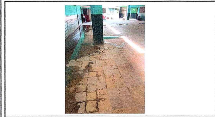
Foto 3: Se observa que el piso de granito se encuentra ya en un mal estado y desnivelado
