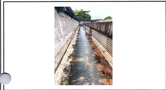
Foto 1: Se observa que la losa no cuenta con caída de agua y se emposa en la parte superior
