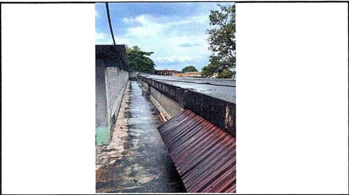
Foto 2: Se observa que la losa tiene filtraciones en el interior
