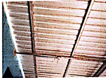
Foto 10: FOTOGRAFIA SUMINISTRO E INSTALACION ESTRUCTURA PORTANT4E DE METAL, LAMINA TROQUELADA CALIBRE 26, SUMINISTRO E INSTALACION SISTEMA ELECTRICO ILUMINACION
