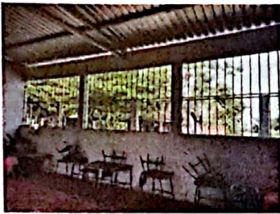
Foto 7: FOTOGRAFIA SUMINISTRO E INSTALACION ESTRUCTURA PORTANT4E DE METAL MAS LAMINA TROQUELADA CALIBRE 26
