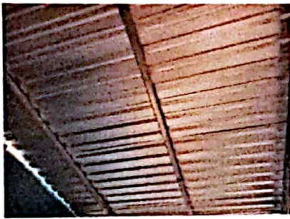
Foto 9: FOTOGRAFIA FOTOGRAFIA SUMINISTRO E INSTALACION ESTRUCTURA PORTANT4E DE METAL MAS LAMINA TROQUELADA CALIBRE 26
