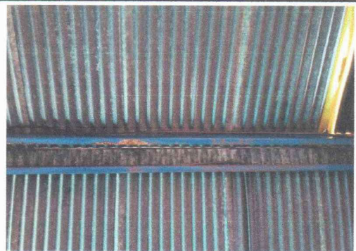
Foto 2: Se observan daños en la estructura del soporte de metal (costaneras), algunas presentan óxido y picaduras, otras solo necesitan mantenimiento, módulo 1.
