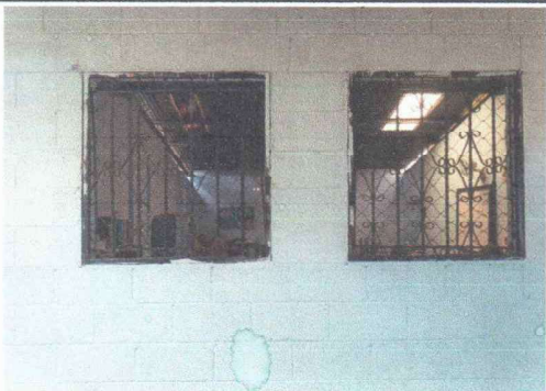
Foto 3: Se observan ventanas del módulo 1, se necesita ampliación para mayor fluidez de aire.
