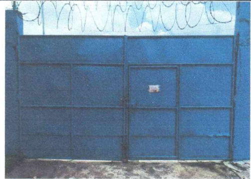
Foto 8: Se observan daños de óxido y picaduras en gran parte de la estructura del portón.
