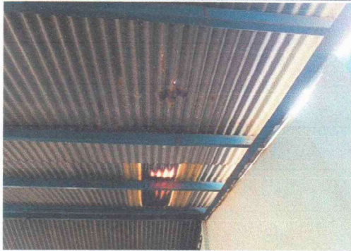
Foto 1: Se observa deterioro por óxido y picaduras en láminas del módulo 1.
