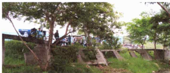
Foto 5: Modulo 2: Reparación de muro perimetral de block con tubo hg y malla galvanizada, soleras intermedias y columnas
