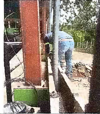
Foto 14: MURO PERIMETRAL: Reparación de muro perimetral de block con tubo hg y malla galvanizada, soleras intermedias y columnas
