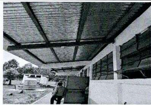
Foto 2: se necesita darle mantenimiento a la estructura de metal existente para evitar su desgaste.
