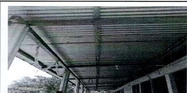
Foto 6: estructura de corredor en mal estado.
