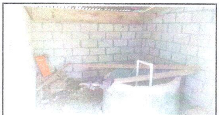
Foto 4: Interior de las instalaciones del pozo.
