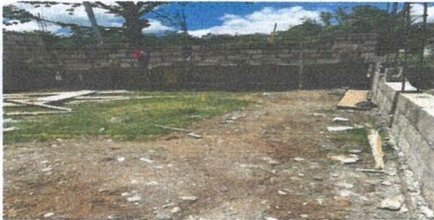
Foto 3: TORTA DE CEMENTO
