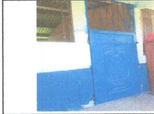
Foto 2: Sustrucción de puerta
